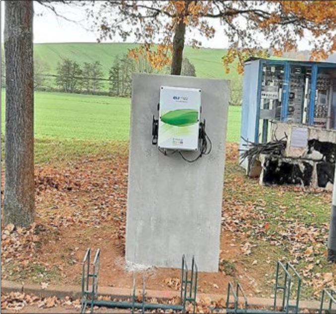
Ladesäule am Grenzlandmuseum, Steele in Maueroptik
